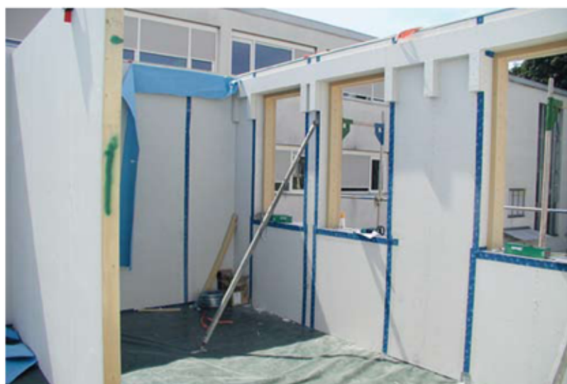
◀ Mit Zementfaserplatten beplankte Randbalken im Bereich der Wandkronen dienen an den Außenwänden als Auflagerkonsole für die Deckenelemente
